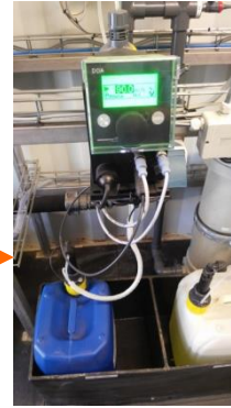
Bomba pedestaltica (Inyección de anti Escalante)
